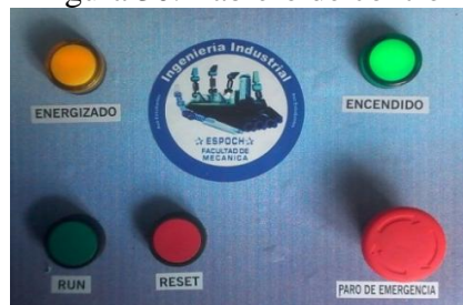
Figura 30. Tablero de control
