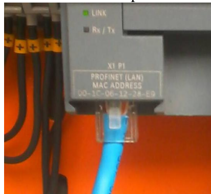
Figura 49 Cable conectado al puerto intranet del PLC
