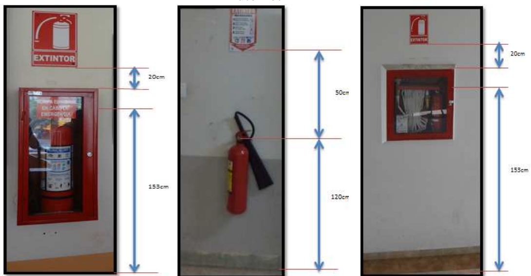
Figura 123. Ubicación de extintores Escuela de Ingeniería de Mantenimiento y Automotriz
