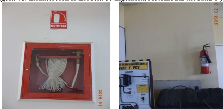
Figura 48. Extintores en la Escuela de Ingeniería Automotriz modular I y II.
