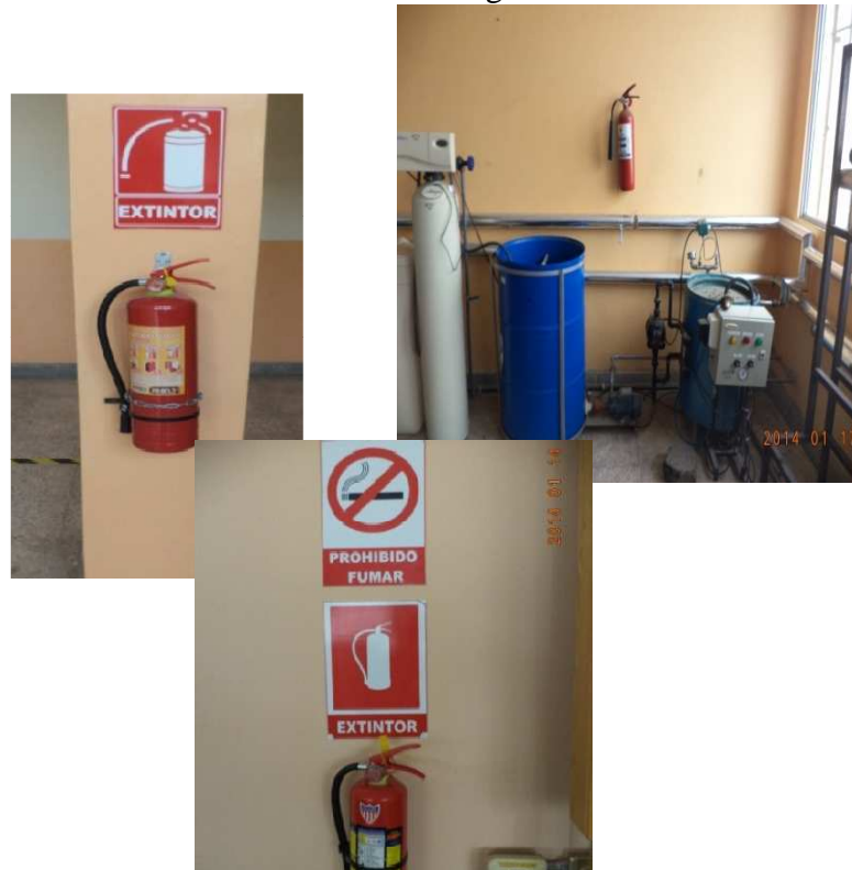
Figura 43. Extintores en la Escuela de Ingeniería de Mantenimiento
