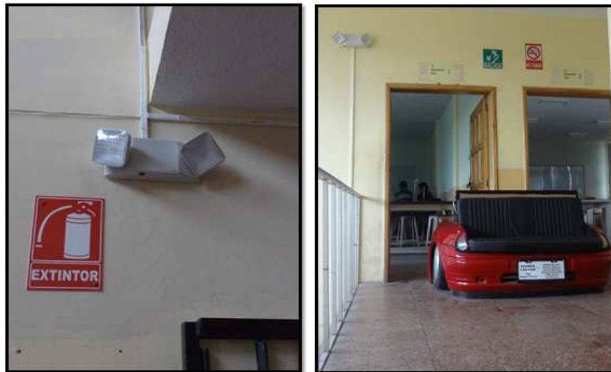
Figura 125. Ubicación lámparas de emergencia en el modular I de Automotriz
