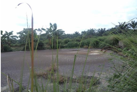
Piscina de Oxidación de PEXA S.A.
