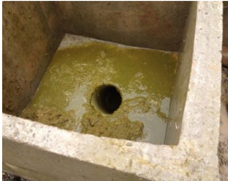
Fotografía 30 Ingreso de la materia orgánica al biodigestor
