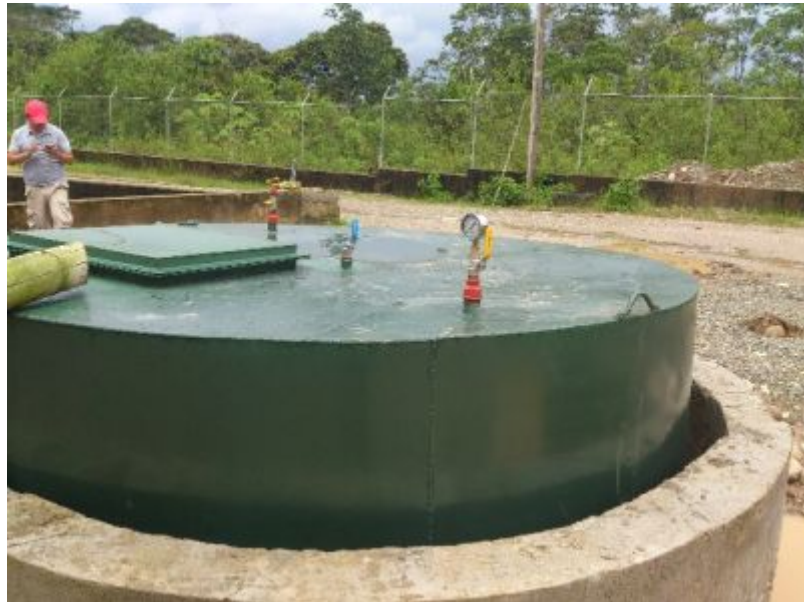
Fotografía 23 Equipos instalados manómetro y flujómetro
