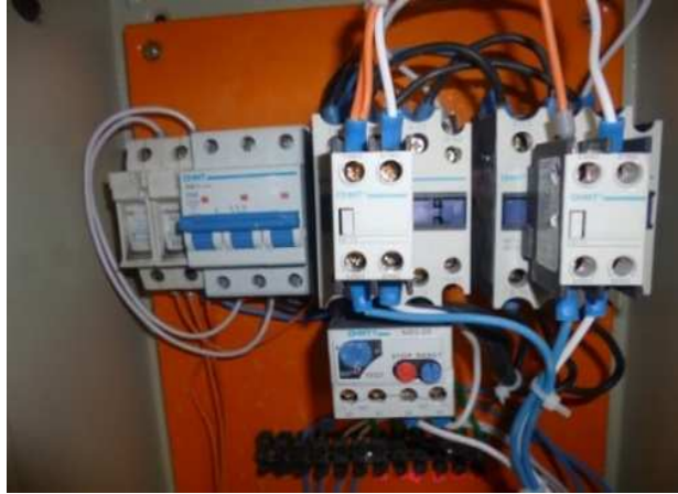
Figura 77. Tablero de control
