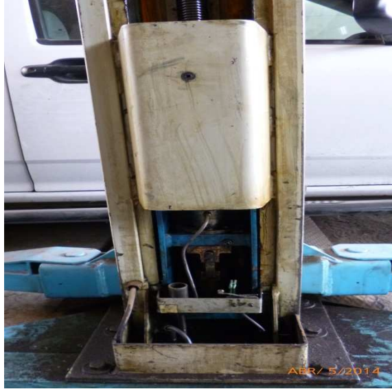
Figura 53. Estado de columna del elevador
