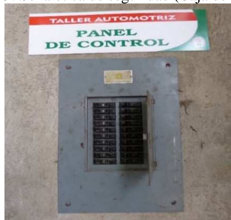
Figura 29. Señalética de seguridad (Caja de breakers)
