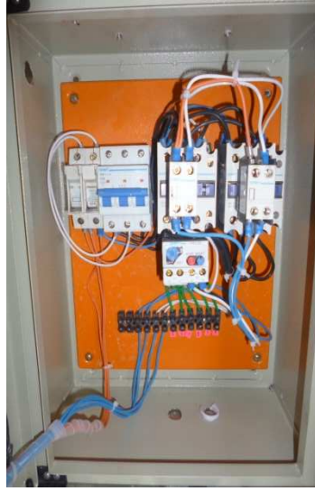
Figura 79. Cableado del tablero de control
