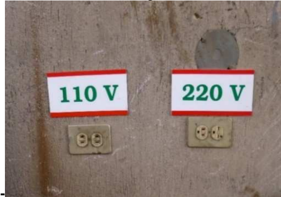
Figura 28. Señalética de seguridad (Tomacorrientes)
