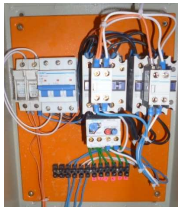
Figura 10. Tablero de breakers
