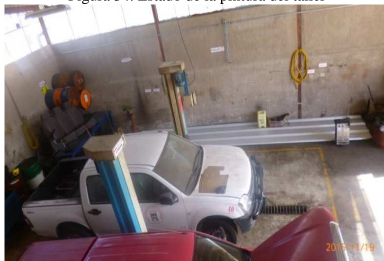
Figura 34. Estado de la pintura del taller
