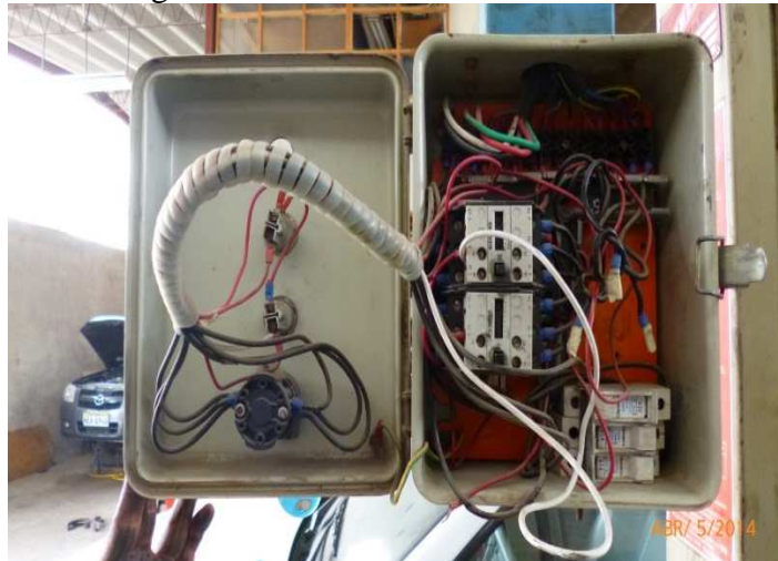
Figura 54. Estado del sistema eléctrico
