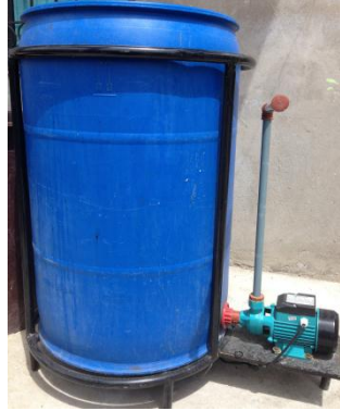
FIGURA 17: TANQUE DE ALMACENAMIENTO DE AGUA Y BOMBA
