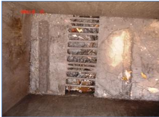
Figura 3.12. Vertido de fluidos en el Taller Mecánico Automotriz.
