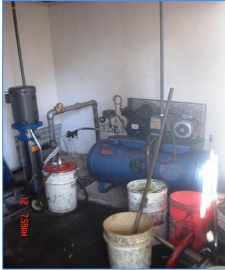
Figura 3.6. Desorden al interior del área de lavado.
