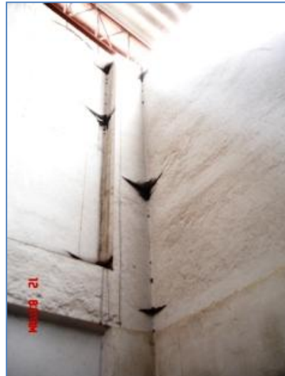
Figura 3.10. Falta de aseo en las instalaciones del Taller Mecánico Automotriz.
