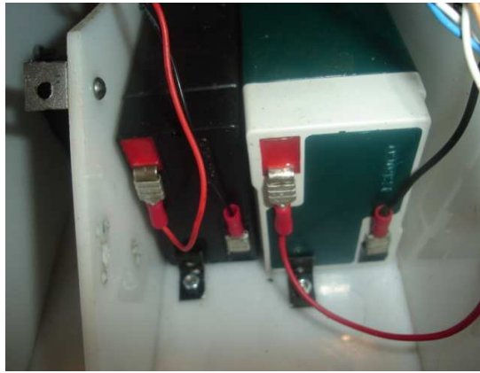
Figura III.15. Ubicación de las baterías del prototipo
