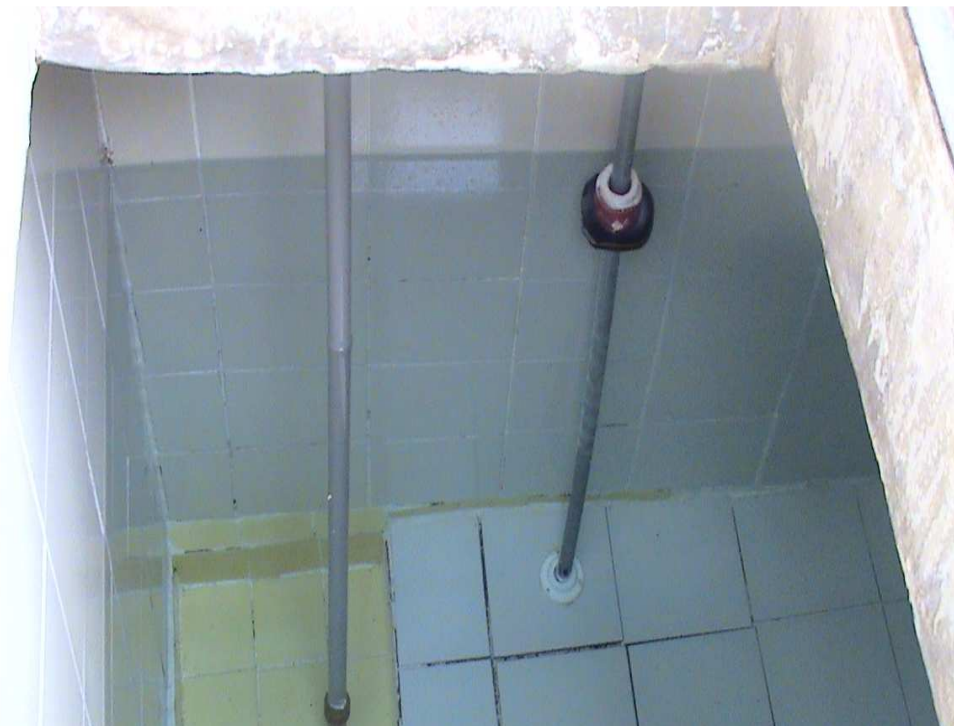
Figura V.I. Sensor de nivel de agua en la cisterna.
