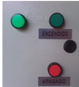
Figura 105. Caja de control
