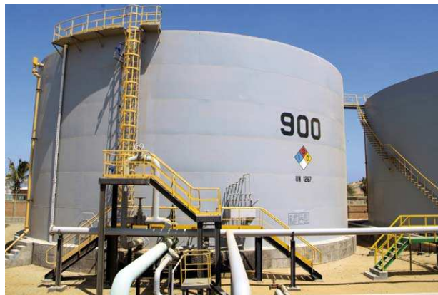
Figura 5. Tanque de Almacenamiento para petróleo.
