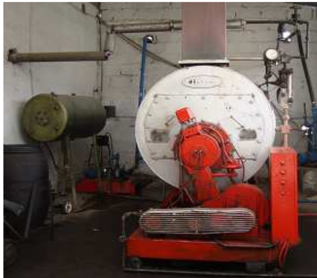
Figura 25. Generador de Vapor
