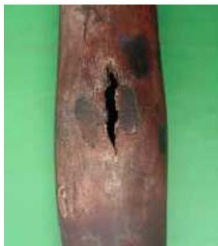
Figura 9. Daño del tubo por sobrecalentamiento
