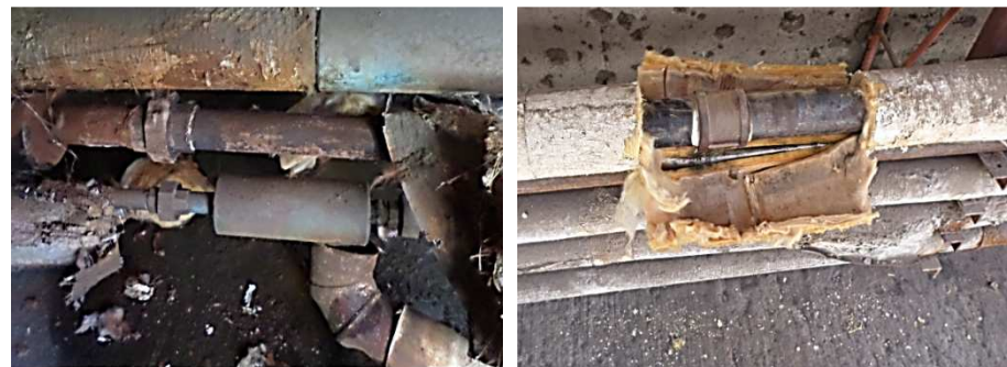
Figura 52. Corrosión externa presente en las tuberías y accesorios
