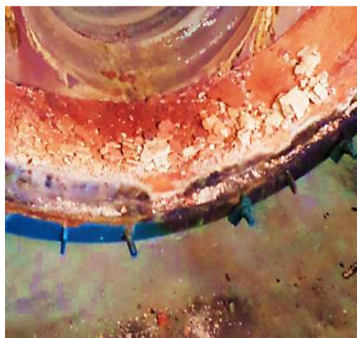
Figura 57. Refractorio deteriorado de la caldera
