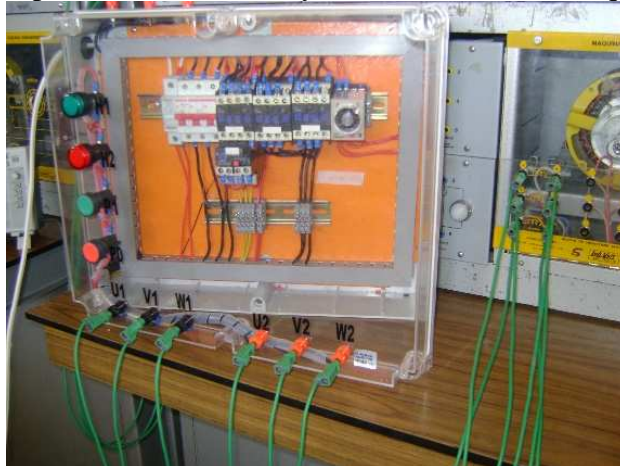
Figura 77. Equipos, aparatos de maniobra y accesorios en el arranque estrella-triángulo
