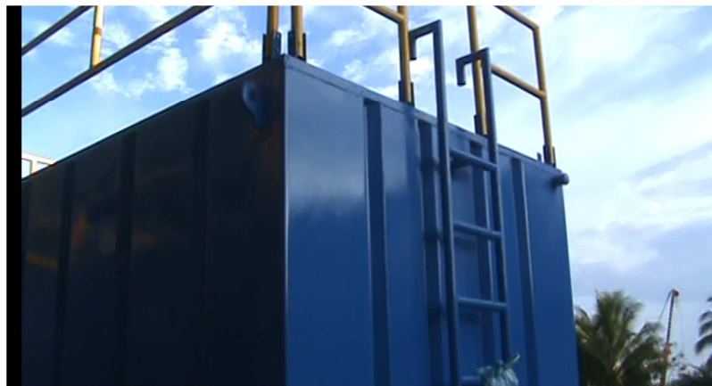
Figura 15. Área de Tratamiento de Aguas - Planta de aguas grises
