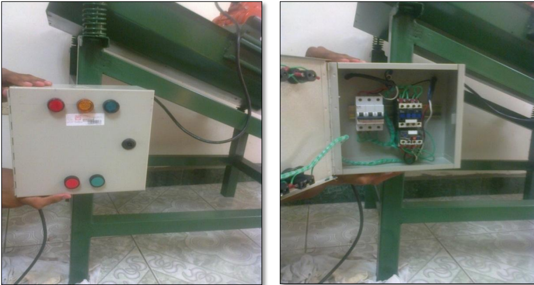
Figura 42. Ensamble botonera, relé térmico y luces
