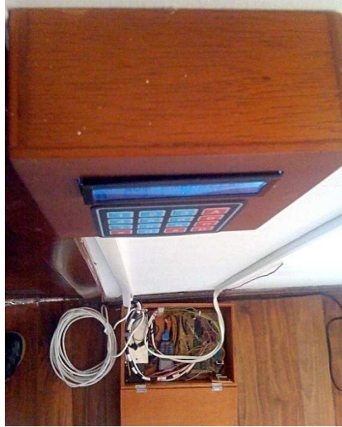
Figura IV.38. Central y panel de control.
