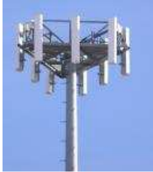
Figura II.7. Típica torre de transmisión de telefonía celular
