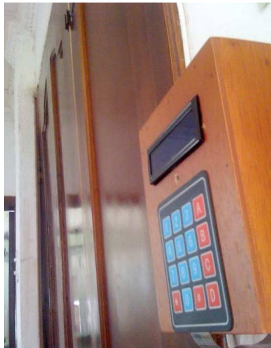
Figura IV.39. Ubicación del panel de control.
