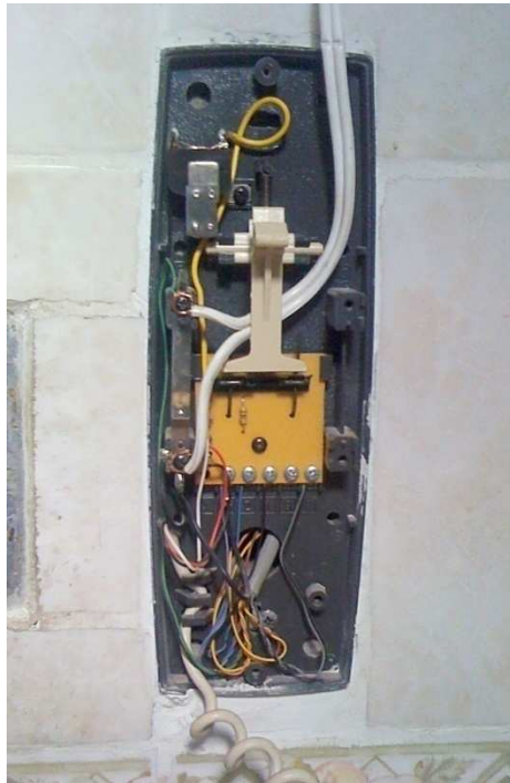
Figura IV.37. Conexiones para cerradura eléctrica.
