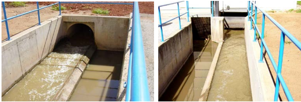
Figura 2. Canal abierto y vista del aliviadero lateral para el agua residual a la Planta.
