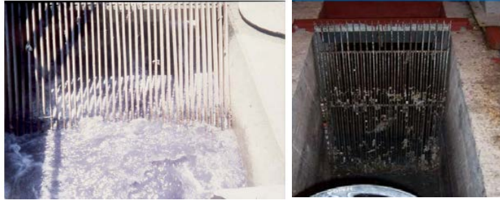
Figura 3. Pre-tratamiento con rejillas de barra metálica paralelas e iguales
