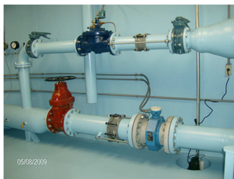
FIGURA 1.3.2.3 Medidor de caudal
