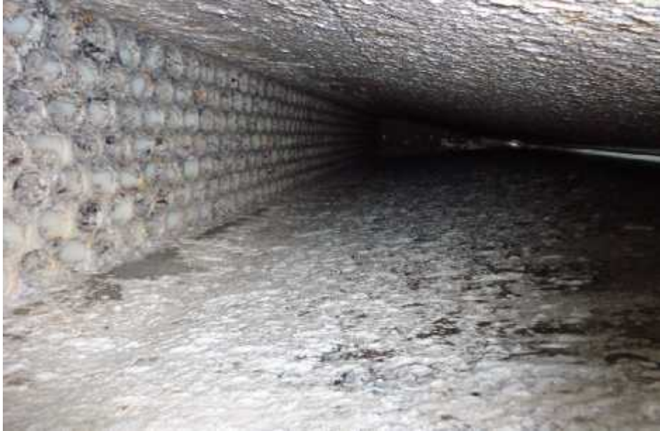
Fotografía 1. Presencia de biofilm en tuberías- Tratamiento con Bactericida DISPRO48
