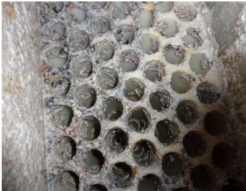
Fotografía 3. Presencia de biofilm en tuberías- Tratamiento con Bactericida Biocatalizador Traclean 60
