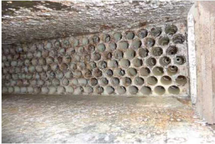
Fotografía 2. Presencia de biofilm en tuberías- Tratamiento con Bactericida Biocatalizador Traclean 60
