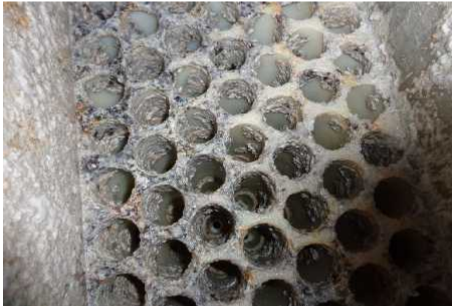
Fotografía 1. Presencia de biofilm en tuberías- Tratamiento con Bactericida DISPRO48
