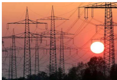
Figura II: 05 Postes de corriente eléctrica de alta tensión
