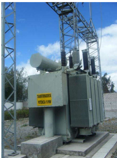
Figura IV: 70 Transformador de potencia 69/13.8kV S/E N° 3
