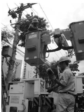
Figura IV: 80 Inyección de las señales PLC en las líneas de media tención
