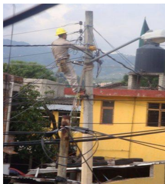
Figura II: 09 Cables de baja tensión
