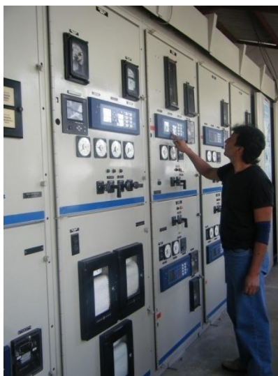
Figura IV: 69 Tablero de comando S/E N° 3
