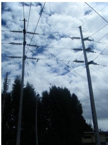
Figura IV: 67 Alimentación de 69kV Subestación No 3
