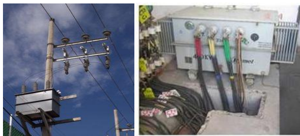
Figura II: 03 Transformador final a 127 V C.A.
