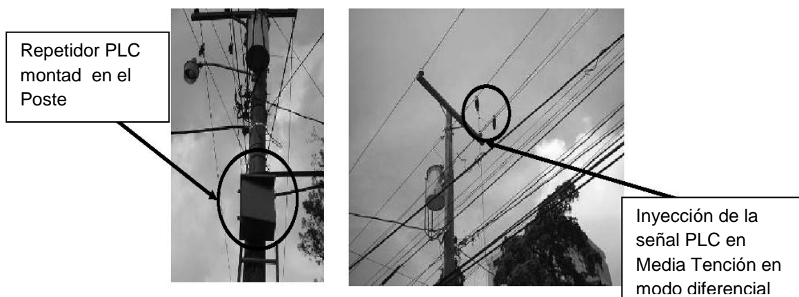
Figura IV: 78 Inyección de las señales PLC en las líneas de media tención
