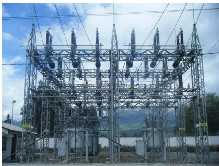
Figura IV: 68 Subestación de Transformación y Seccionamiento
