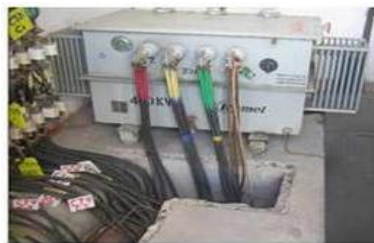
Figura II: 07 Líneas subterráneas de transmisión eléctrica
