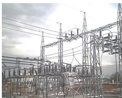
Figura II: 02 Estación transformadora elevadora
