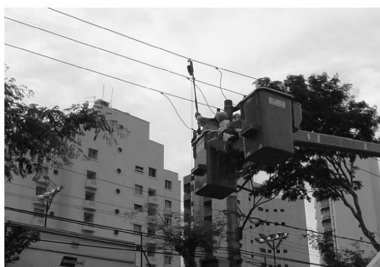
Figura IV: 79 Inyección de las señales PLC en las líneas de media tención
