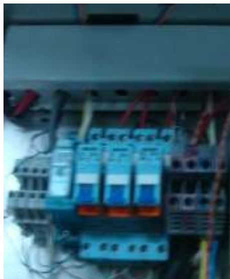
Figura N° IV.13. Borneras y regletas.
