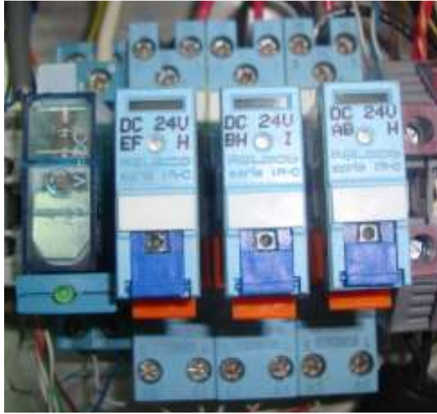
Figura N° IV.12. Relés de control.
