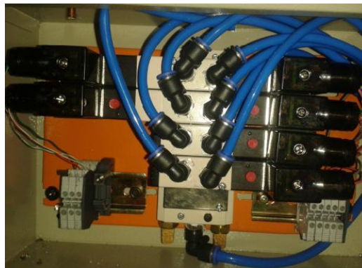
Figura IV-38 Implementación parte electropneumática.
