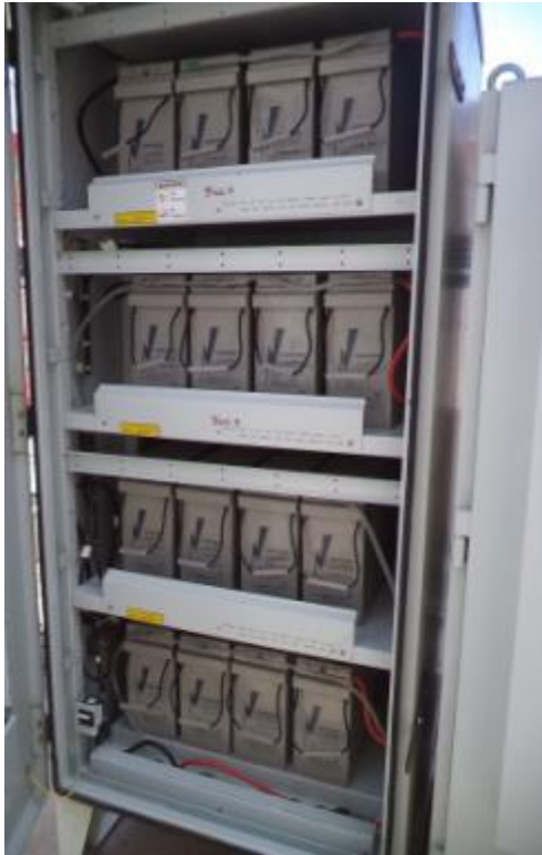
BANCO DE BATERÍAS
