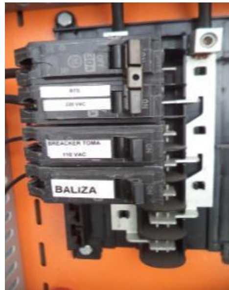
TDP TABLERO DE DISTRIBUCION PRINCIPAL
