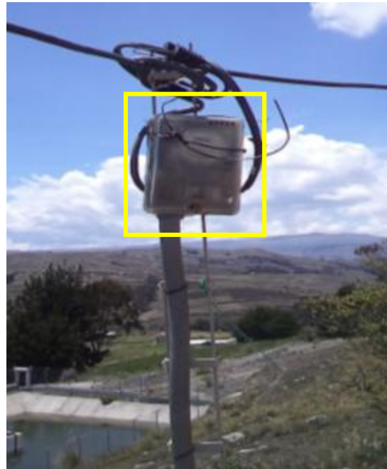
MEDIDOR DE ACOMETIDA ELECTRICA
