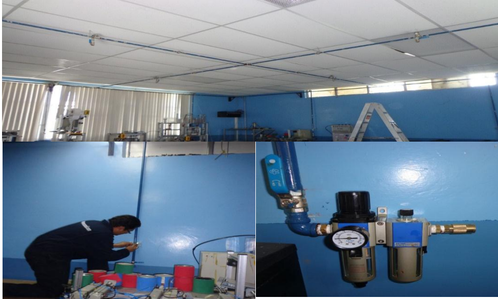
Figura LXVII. Instalación de la tubería de servicio y dispositivos de control en los puntos de consumo.
