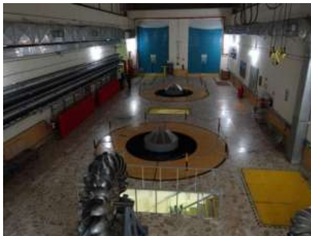
FIGURA IV.49. Central Hidroeléctrica Pucará Fuente: CELEC EP - Hidroagoyán
