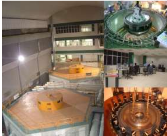
FIGURA IV.51. Central Hidroeléctrica San Francisco Fuente: CELEC EP – Hidroagoyán
