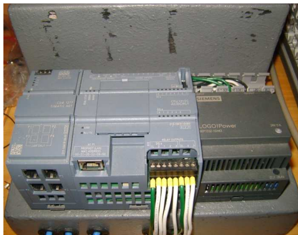
Figura 34. Ubicación del PLC, compact switch y fuente de poder.
