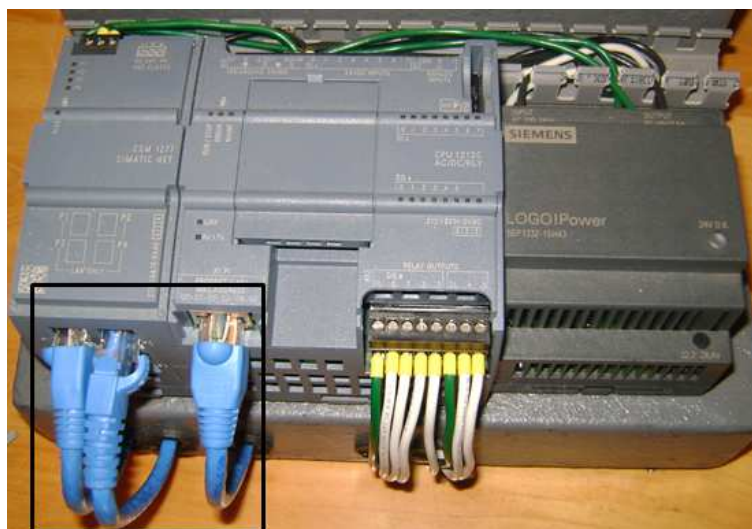
Figura 50. Conexión del compact switch al PLC y pantalla táctil
