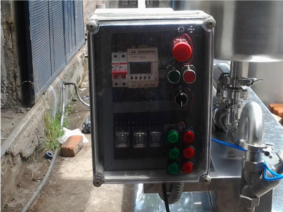
Fuente: Marco Vinicio Correa Castro (Autor) Figura IV. 61. Sistema eléctrico y control
