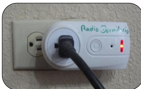
Figura 100. Instalación del sensor “smart plug”
