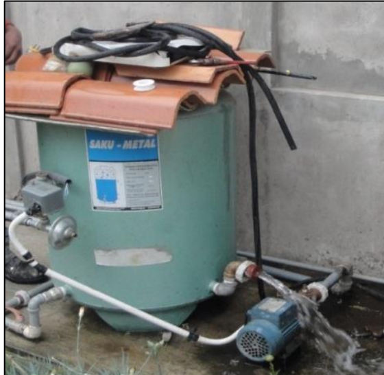
Figura 52. Vaciado de agua
