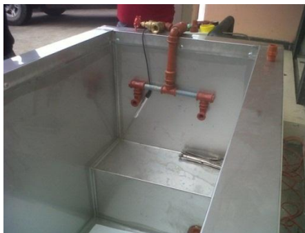
Figura 101. Interior del tanque en acero inoxidable.
