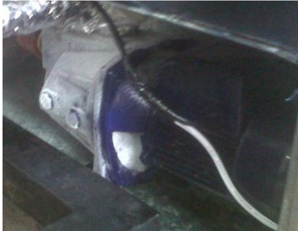
Figura 100. Bomba de suministro al intercambiador.
