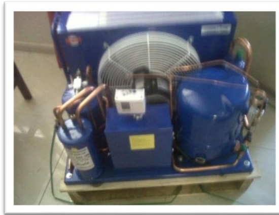
Figura 77. Unidad condensadora seleccionada
