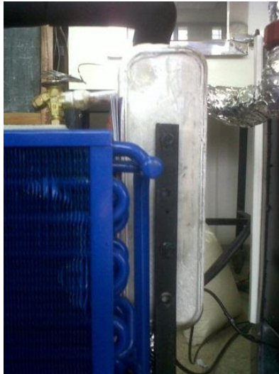
Figura 96. Posición del intercambiador de calor de placas.
