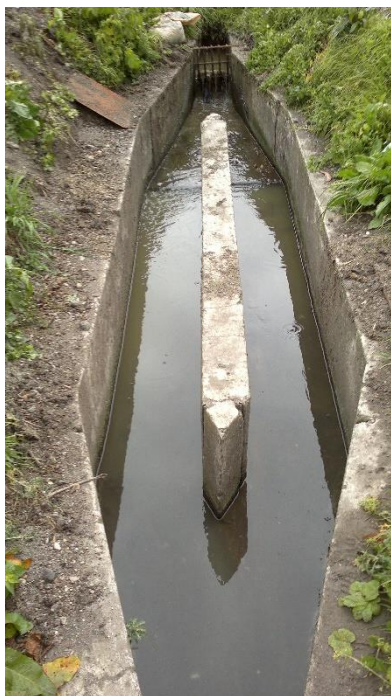
c.) Resultados de la re-instalación de las rejillas y la limpieza de los desarenadores.
