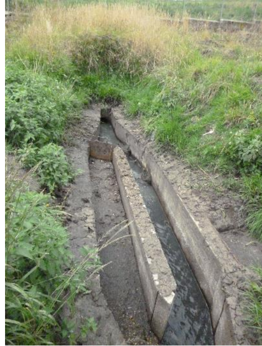
b.) Canal de entrada, rejillas, y desarenadores
