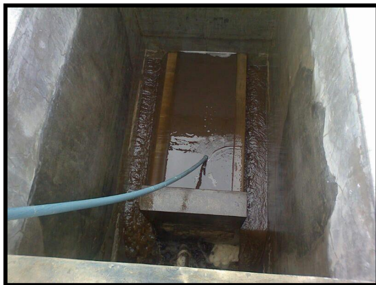
Figura h- Filtración
