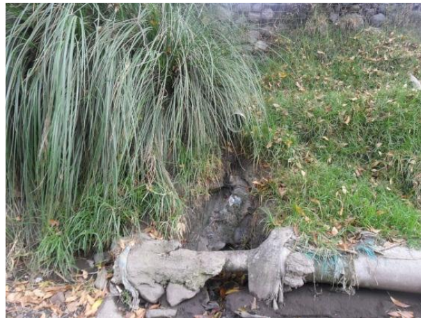
FOTOGRAFÍA No. 9 Descarga de agua residual.
