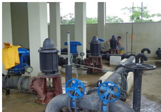
Figura. 30: Cuarto de bombeo.
