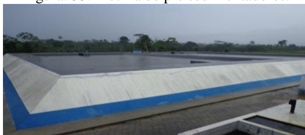
Figura. 33: Piscina de pre sedimentadores.
