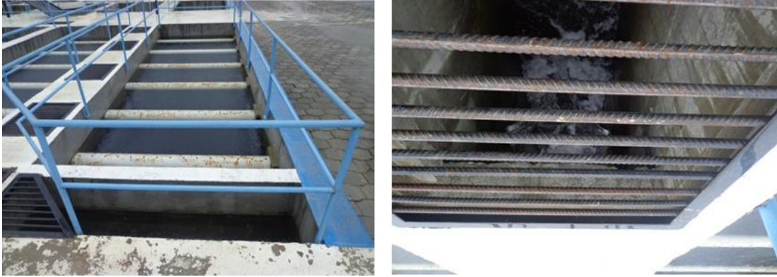
Figura. 24: Unidad de sedimentación.
