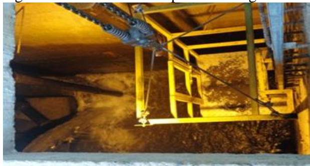
Figura. 36: Cárcamo de captación de agua cruda.
