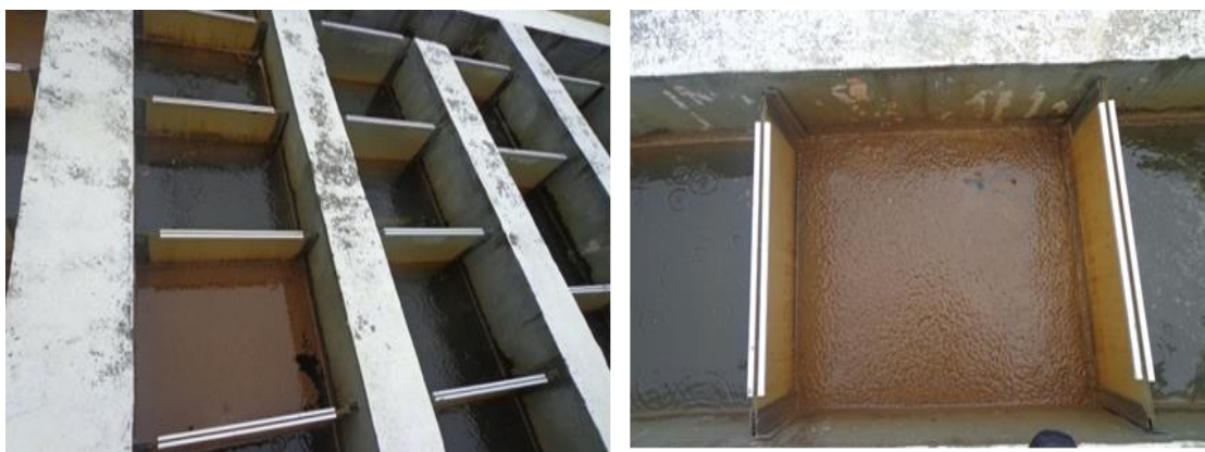
Figura. 23: Unidad de floculación.
