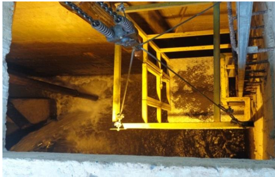
Figura. 48: Cárcamo de bombeo.
