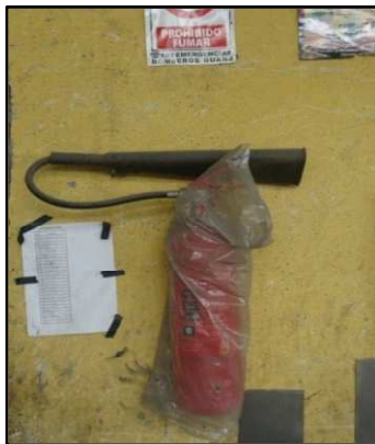
Figura 24: Extintor de la planta.
