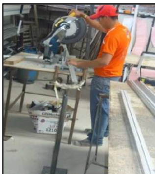
Figura 28: Falta de EPI.
