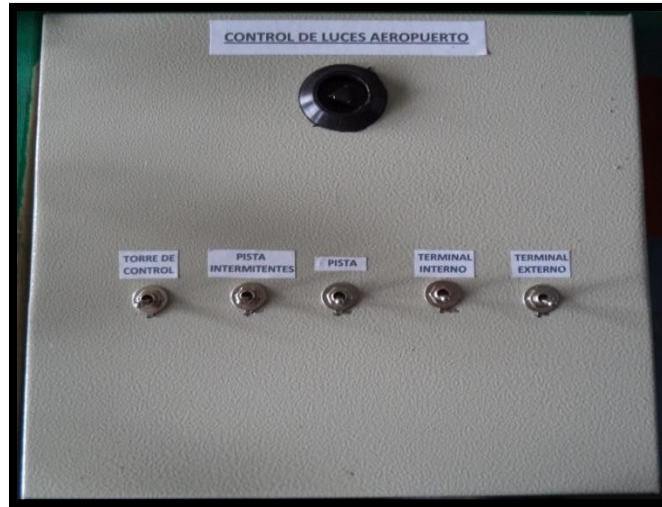
Figura V-28 Tablero de Control de Luces 104
