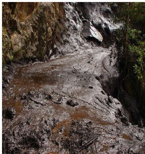
Foto 41. Derrumbes causado por la erosión hídrica. Fuente: Saransig, R. 2008
