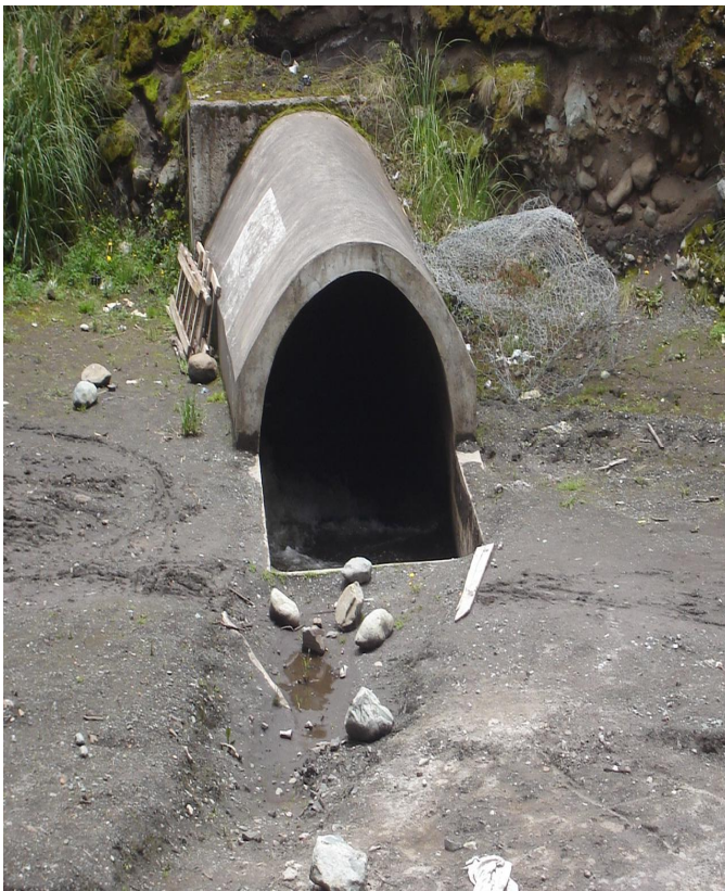
FOTO 5: Túnel Sistema Guargualla-Licto
