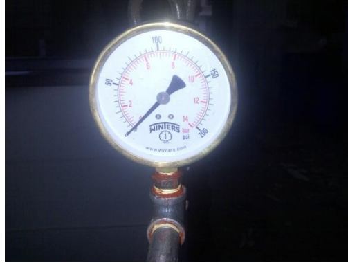
Figura III.23. Manómetro para caldera
