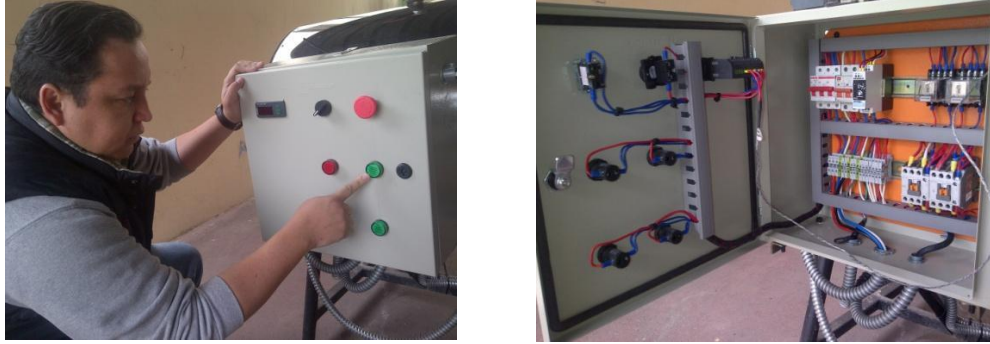
Figura VI.29. Tablero de control
