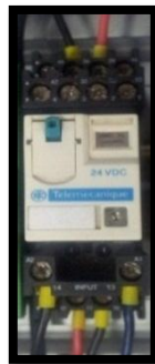
Figura IV-56. Relé que activa el motor de la mesa giratoria de indexación 98
