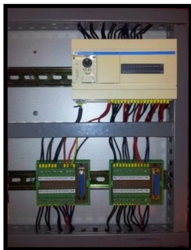
Figura IV-58. Panel de control del PLC 100
