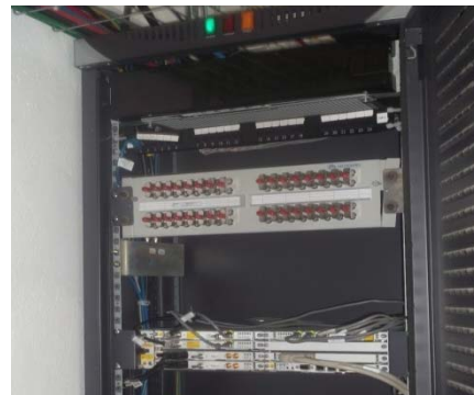
Entradas de fibras y E1 a los equipos
