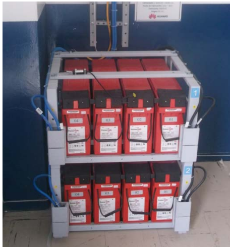
Equipos de energía (baterías)
