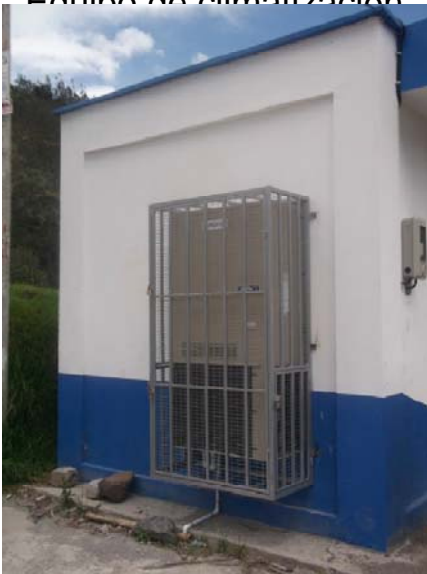
Equipo de climatización
