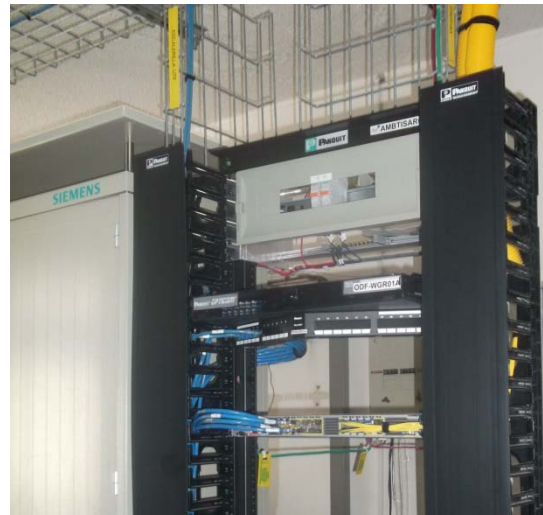
Router y conversor óptico-eléctrico
