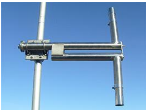
Figura II. 10 Dipolos de alta potencia
