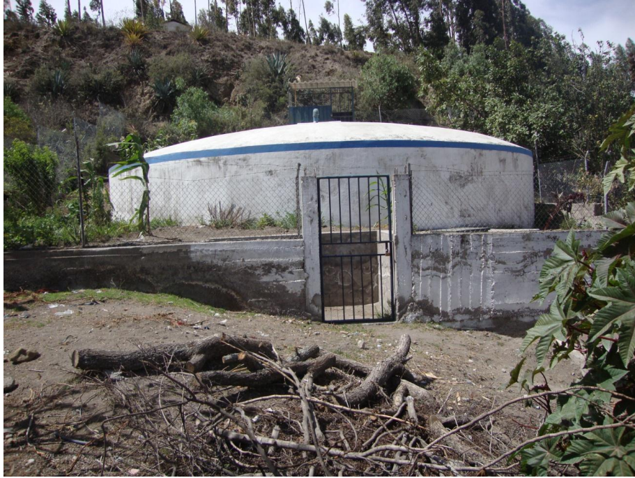
Fotografía N°5. Tanque de Distribución de la Inmaculada
