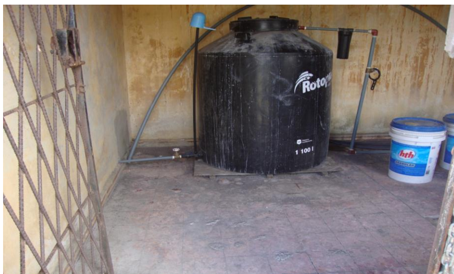
Fotografía N°3. Parte interna del área de cloración del tanque de distribución de Lluishi
