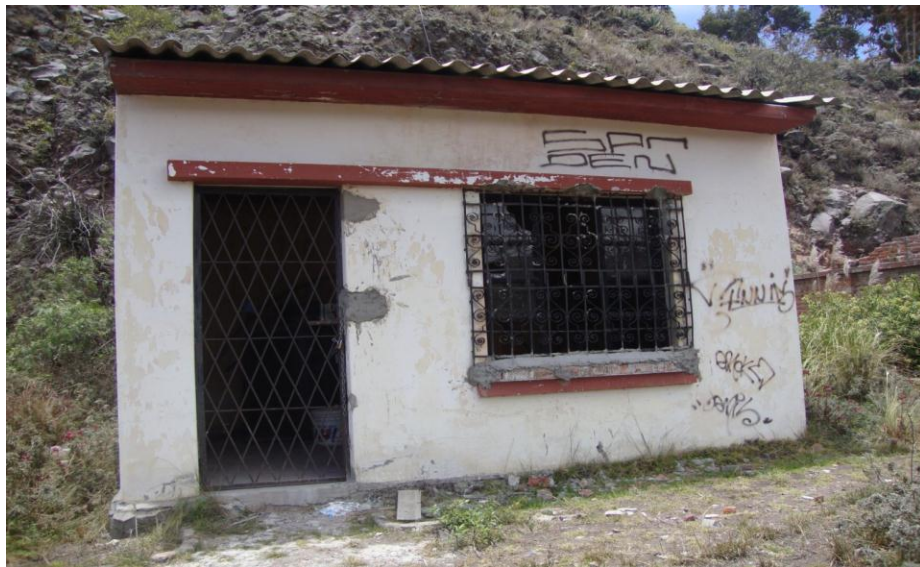
Fotografía N°2. Área de cloración del tanque de distribución de Lluishi
