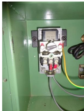
Figura 58. Mantenimiento del dispositivo de control de presión
