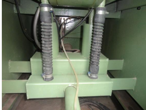
Figura 68. Cañerías nuevas de las cámaras de refrigeración
