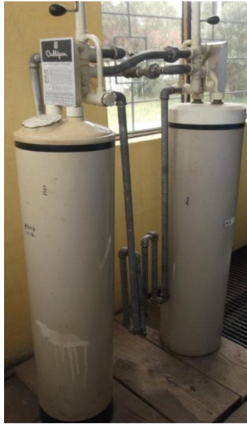
Figura 26. Descalsificador de agua
