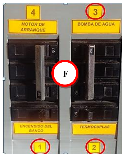
Figura 90. Accionamiento del encendido del banco, termocuplas y bomba de agua
