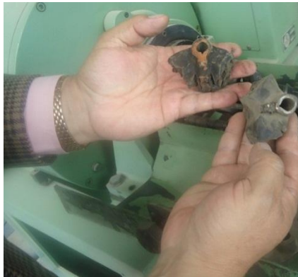
Figura 29. Acoplamiento flexible roto
