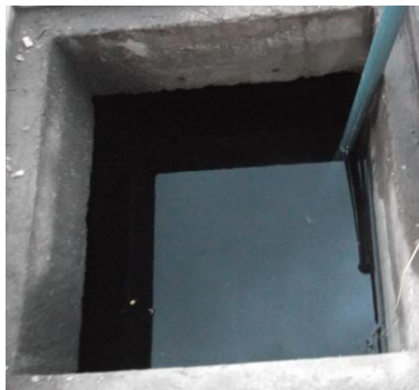
Figura 19. Agua de la cisterna
