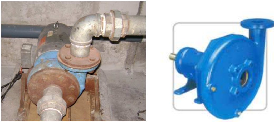
FIGURA 26. Bomba de agua centrifuga del sistema actual
