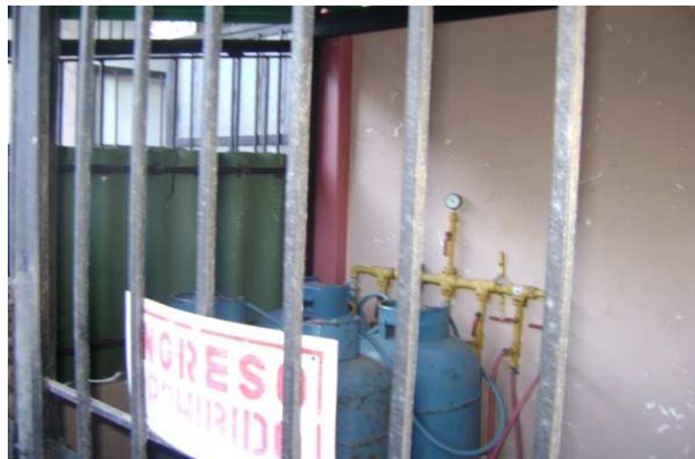
FIGURA 23. Centralina 1 de gas del sistema actual
