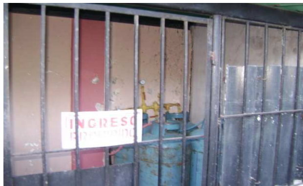
Figura 24. Centralina 2 de gas para el sistema actual
