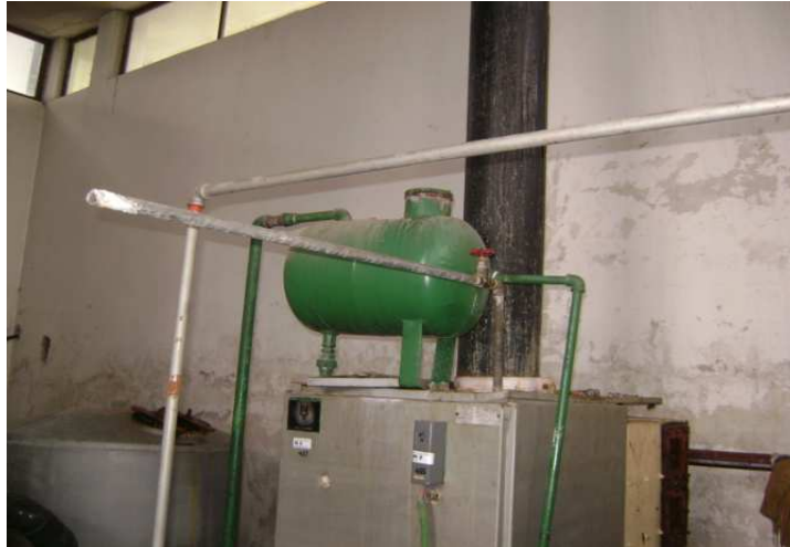
FIGURA 33. Deterioro de las tapas de los calentadores.
