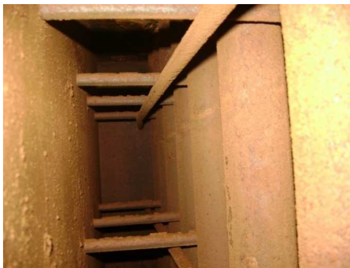
FIGURA 34. Corrosión y óxido de los calentadores actuales
