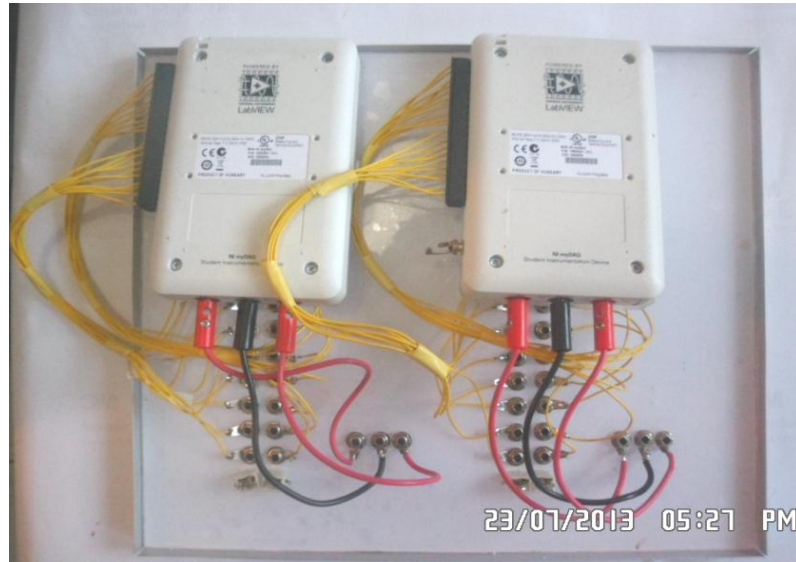
Figura 109. Cableado interno del módulo EM-001
