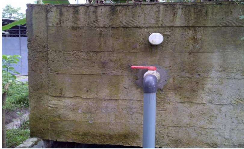
Fotografía 11. Tanques 2 de sedimentación.
