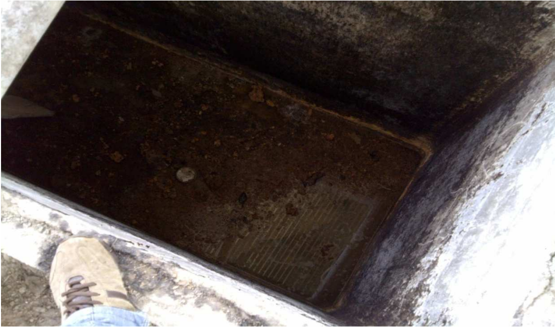
Fotografía 10. Primer tanque de sedimento después del tanque recolector.
