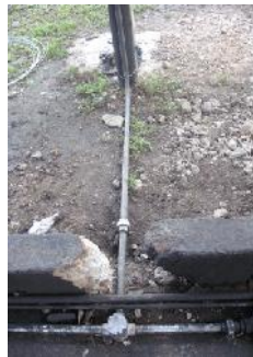
Fig. V. 6. Tubería para cada tablero
