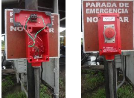
Fig. V. 44. Parada de emergencia caseta Power Oil.
