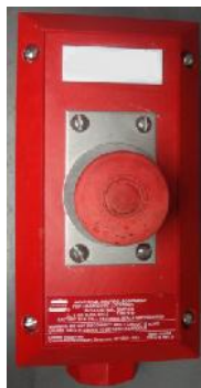
Fig. IV. 12. Caja Sistemas de Alarma
