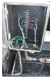
Fig. V. 14. Unidad Power Oil dos.
