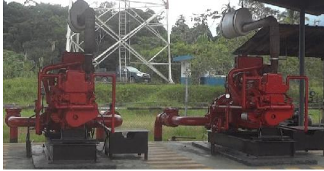
Fig. III. 24. Sistema de bombeo del SCI
