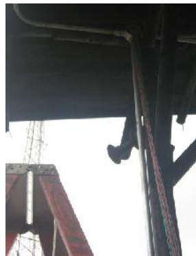
Fig. V. 11. Conductores hacia detectores UV/IR Fuente: Estación Sansahuari
