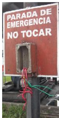
Fig. V. 15. Paro de emergencia
