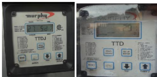
Fig. VI. 8. Señal de alarma del paro de emergencia, controladores Murphy
