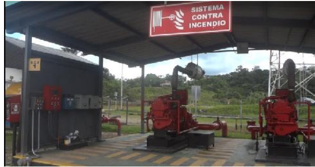
Fig. VI. 6. Bombas de agua SCI.
