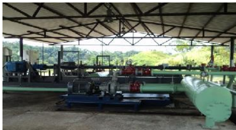
Fig. III. 10. Bomba Horizontal Sistema de Reinyección Fuente: Estación Sansahuari
