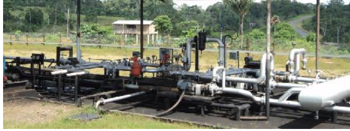
Fig. II. 11. Sistemas Bombas BOOSTER
