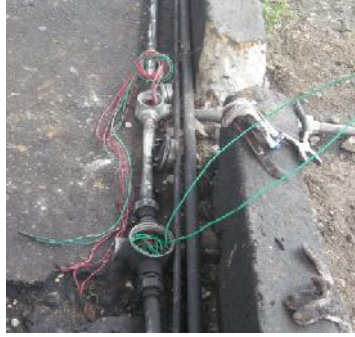
Fig. V. 12. Llegada de conductores al área de las Unidades Power Oil.
