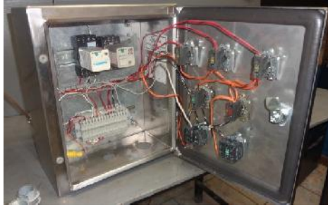
Fig. V. 23. Elementos de control instalados.
