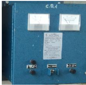
Fig. IV. 16. Cargador de baterías
