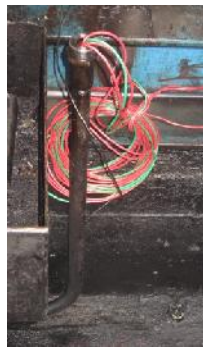
Fig. V. 13. Unidad Power Oil uno.
