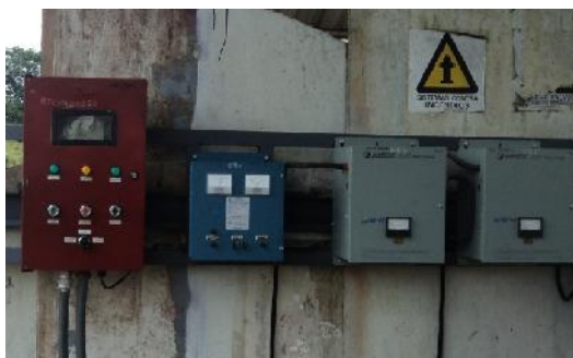
Fig. III. 18. Tablero del Sistema contraincendios actual
