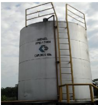
Fig. III. 21. Tanque de diesel
