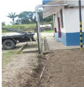
Fig. V. 4. Tubería Paro de emergencia. Fuente: Estación Sansahuari
