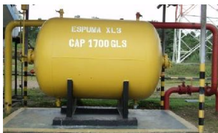
Figura. III. 20. Tanque de espuma SCI Fuente: Estación Sansahuari
