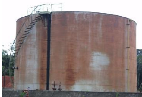
Fig. III. 9. Tanque de reposo Fuente: Estación Sansahuari
