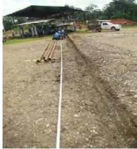
Fig. V. 5. Tubería área Power Oil
