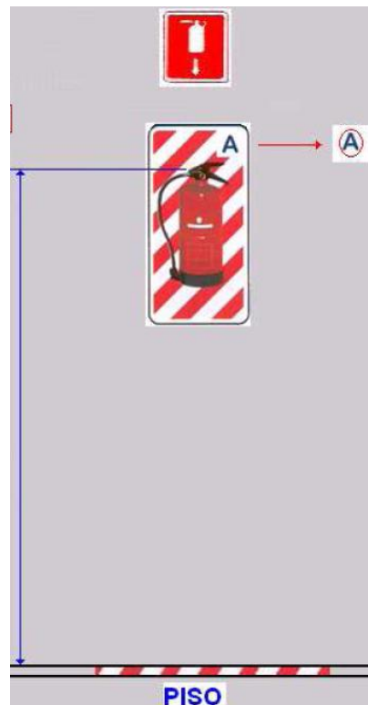
Figura 38. Ubicación y señalización adecuada del extintor
