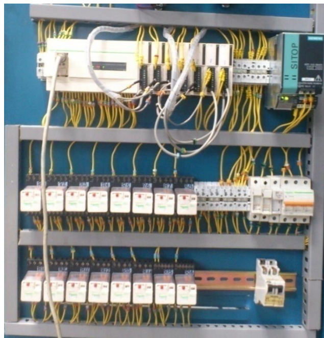
Figura III-41 Etapa de control de Temperaturas
